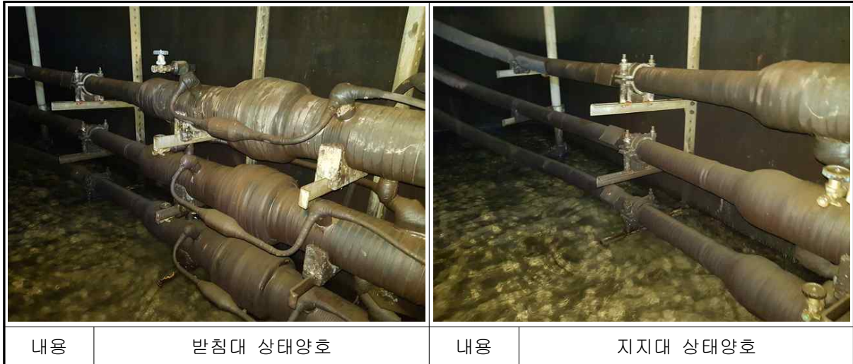
【사진 8.8】 부속 및 부대설비 현황
