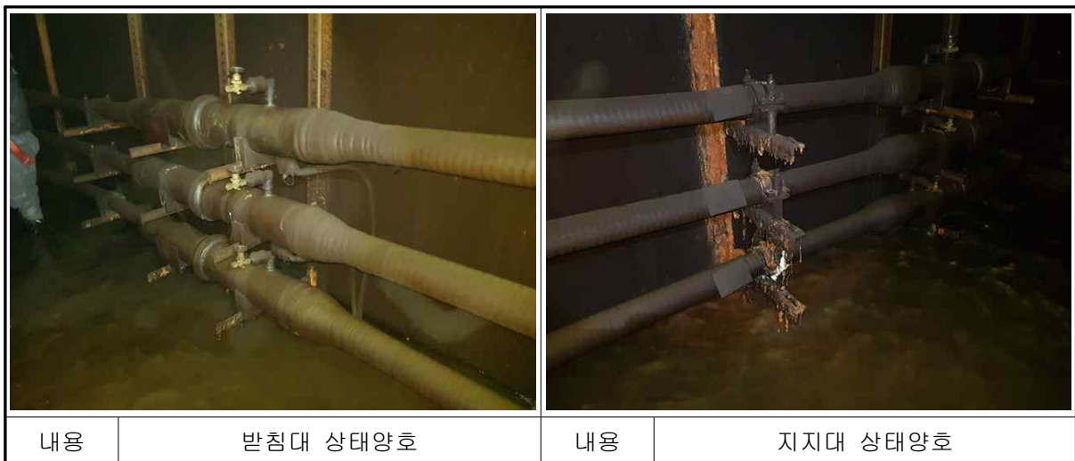
【사진 8.4】 부속 및 부대설비 현황
