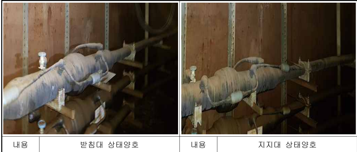
【사진 8.12】 부속 및 부대설비 현황
