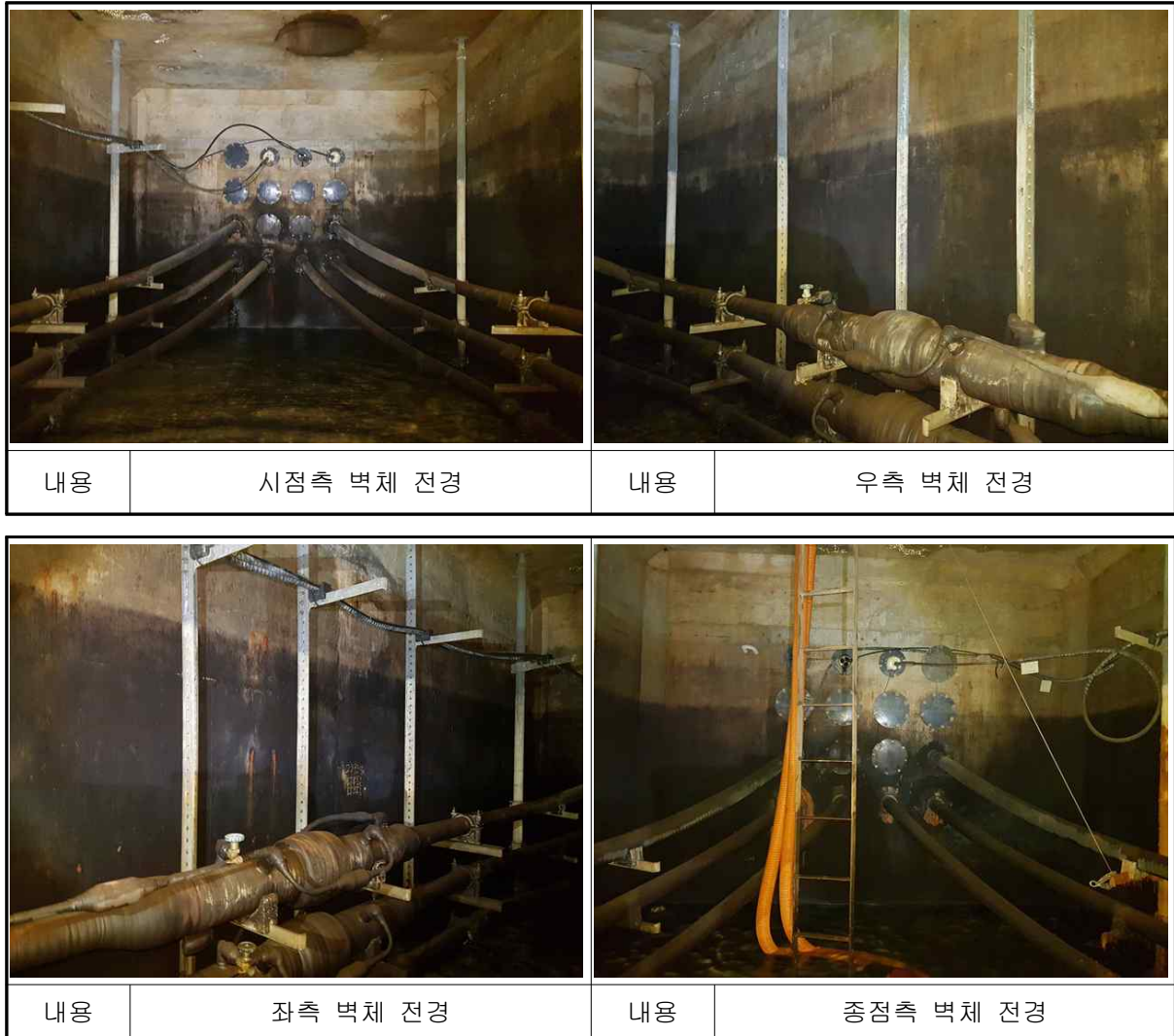
【사진 8.5】 지도~능곡 #13 전경
